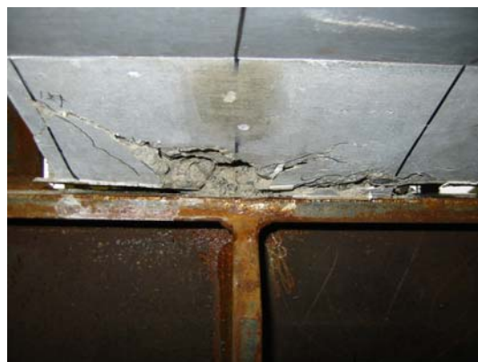
写真-1 ジベル位置のひび割れ状況
