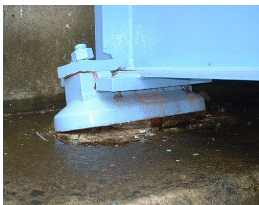
図-4 支承の破損状況
