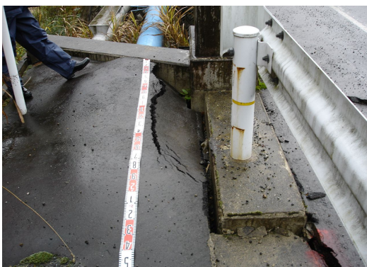
図-5 橋台背面沈下
