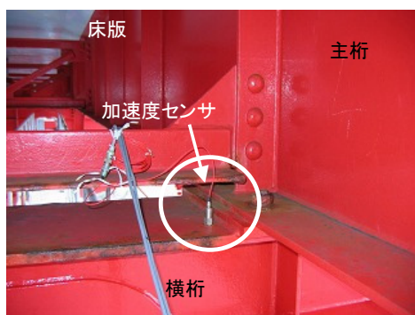
a) 設置状況
