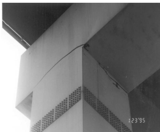
図-1 脆性き裂発生例
