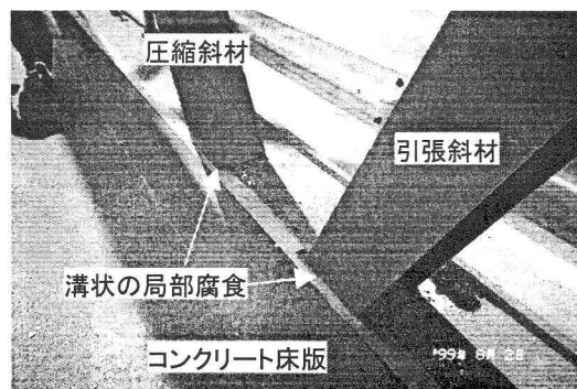
図-3 腐食したワーレントラス橋の斜材
