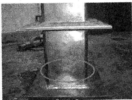
写真-4 柱基部の損傷状況
