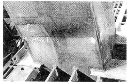
(a) Pier Aの基部付近の座屈変形
