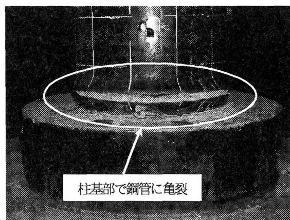
図-14 CFT 柱の損傷状況 (柱基部 \pm 8\delta_y )
