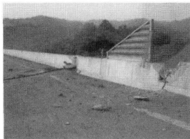
(c) 飛雪防止柵の破損 （板谷沢橋）
