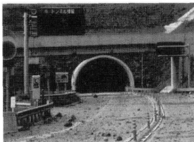
(b) 噴石飛来による損傷 （洞爺トンネル付近）
