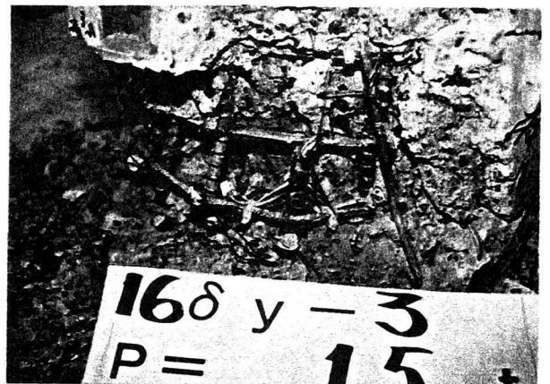
写真-1 基部での損傷状況
