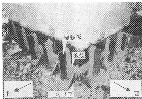
写真-1 鋼製橋脚基部の三角リブ上端部に生じた亀裂 (溶接補修され矩形リブで補強されている)
