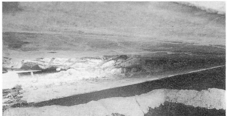
写真-5 鋼板接着床版の崩壊状況(下面)
