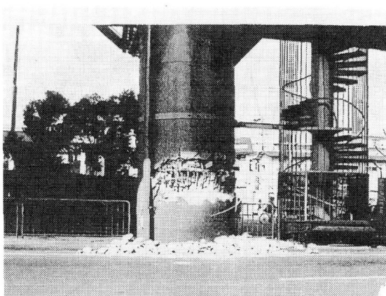
写真-3 円形R C橋脚下部の圧壊
