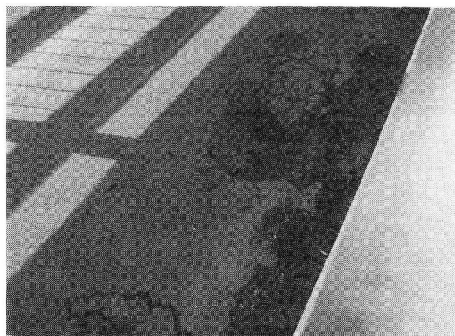
写真-1 損傷状況の一例
