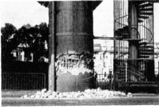
写真1 衝撃破壊が発生した状況 10)
