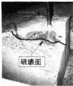
図 10 破壊面の状況(F0.7)
