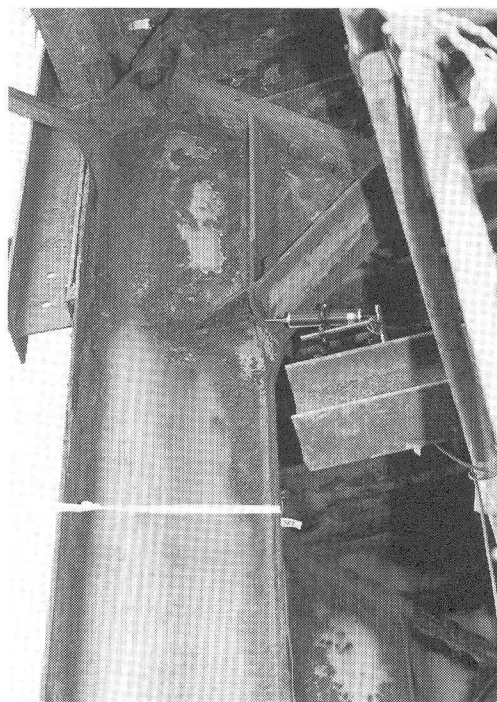
写真-2 海側柱の局部座屈
