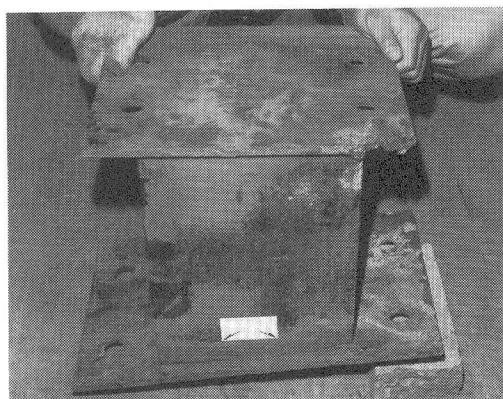
図-5 垂直材クラック状況写真(1)
