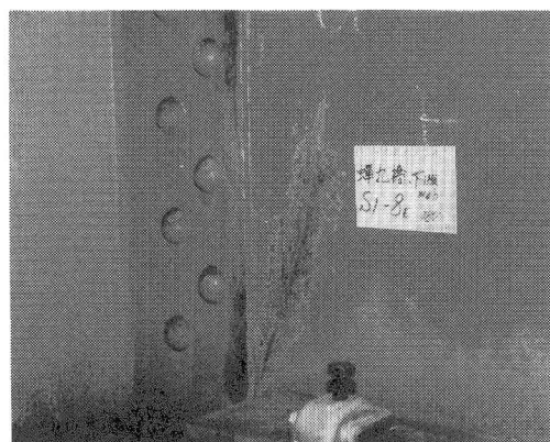
図-8 縦桁クラック状況写真(1)
