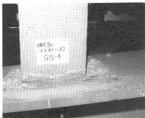
図-6 垂直材クラック状況写真(2)
