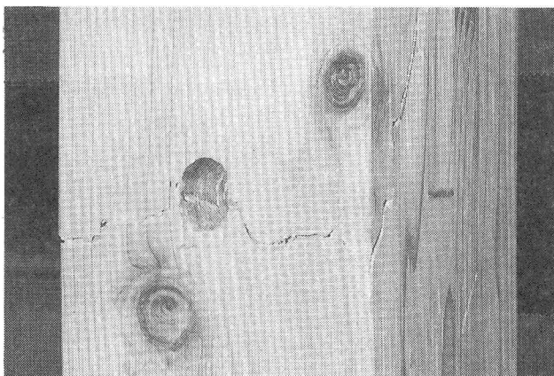
写真-2 支柱-床版接合部の破損状態
