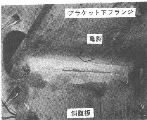
写真-5 亀裂の外観
