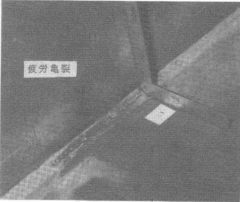
写真－2 かど継手に発生した疲労亀裂
