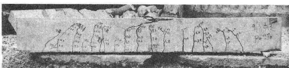
写真-1 連結部材および単体部材の破壊状況
