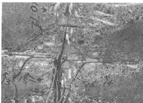
写真-3 №2 配線状況
