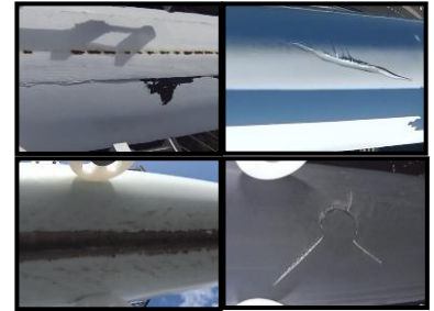
図1 ケーブル変状例
