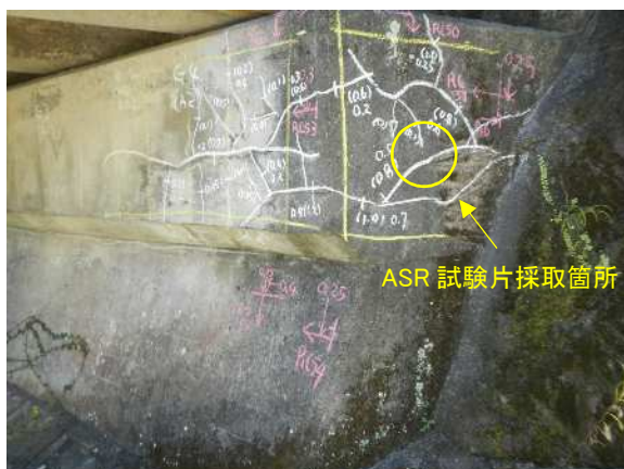
写真-2 橋台端部の不規則なひびわれ (A2 橋台)
