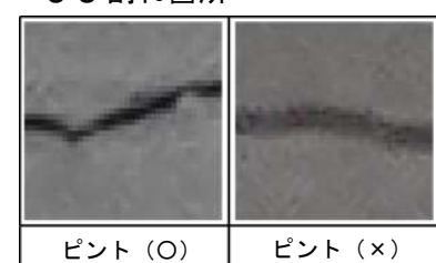
図 3 ピントによるひび割れ箇所の見え方の違い
