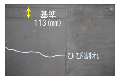
写真 4 内空高 5.5m 位置のひび割れ箇所
