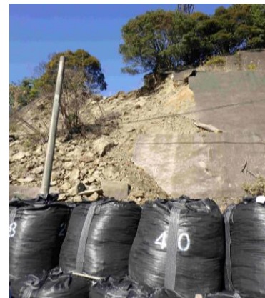
写真-1 斜面の崩壊の写真
