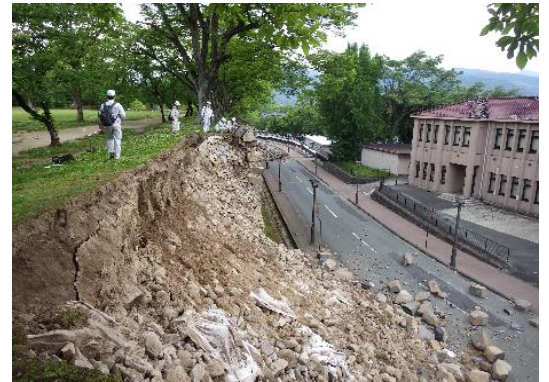
写真-1 背面土崩壊石垣の様子
