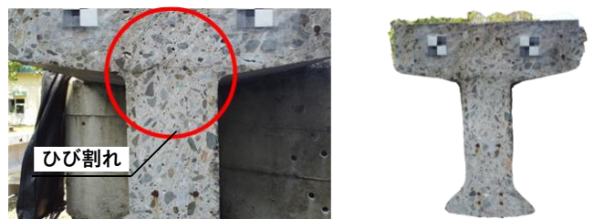
(a) デジタル写真 (b) 復元された 3D モデル 図-2 解体橋梁桁のひび割れ発生状況
