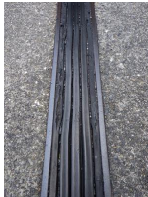
写真 5 伸縮装置の破損
