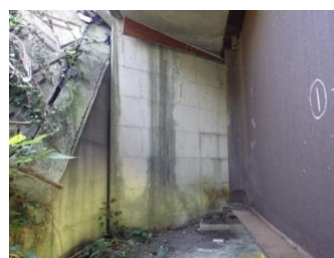
写真 7 桁端部の漏水
