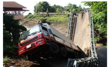
写真 2 過積載車両による落橋
