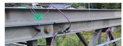
写真 3 主構上部の補強部材
