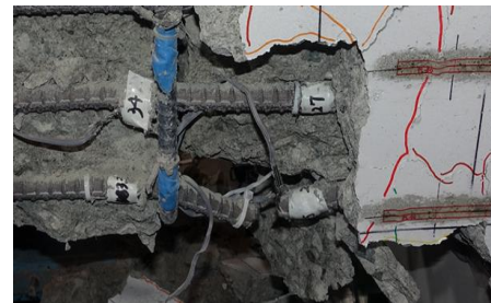
写真-2 タイプ2の主鉄筋破断状況
