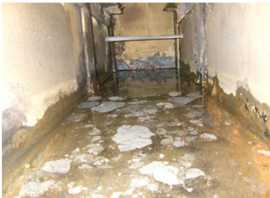
図-1 鋼製高欄内部の滞水・腐食状況 1)
