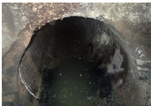
写真-1 下水道管渠の損傷状況
