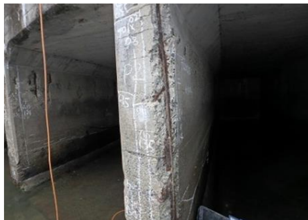
写真-1 塩害による鉄筋露出（隔壁）
