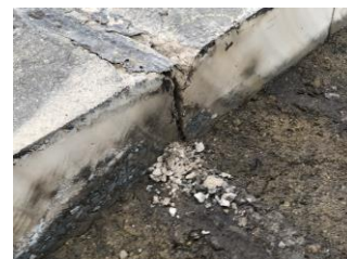
写真-1 雨水浸透による路盤劣化状況
