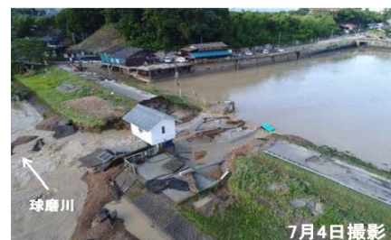
図1 八久保排水樋管付近堤防決壊状況 1)
