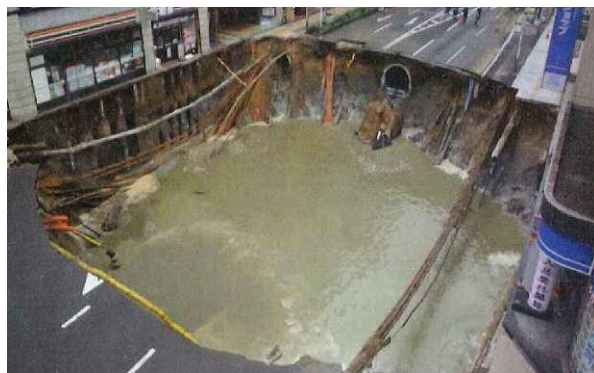
図-4 JR博多駅前で発生した道路陥没
