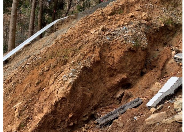
写真－2 YT-15 の斜面左側
