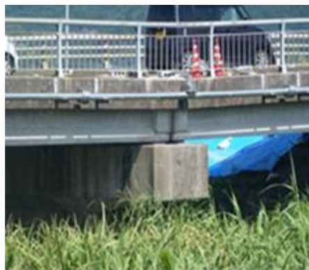
写真-1 中間橋脚の沈下現象
