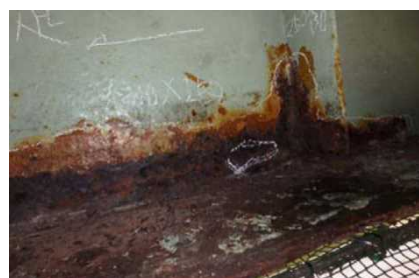
図 2 橋梁の下フランジの腐食状況
