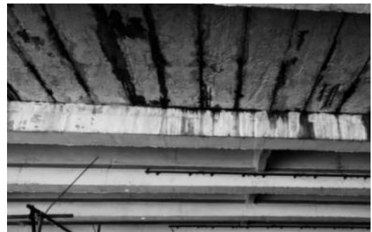
写真-1 小海河旧橋の橋桁下面損傷 1)
