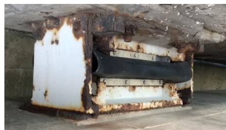
図 3 腐食した 1 本ローラー支承
