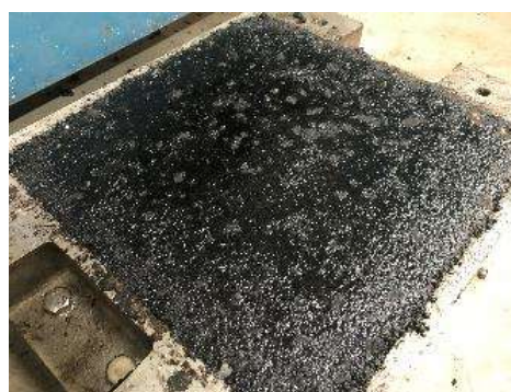
写真-1 アスファルトのにじみ出し
