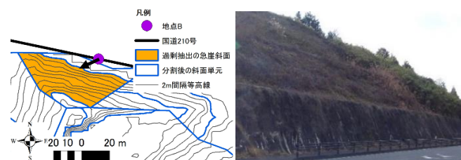
図 9 過剰抽出の切土のり面（左図）と現場写真（右図）
