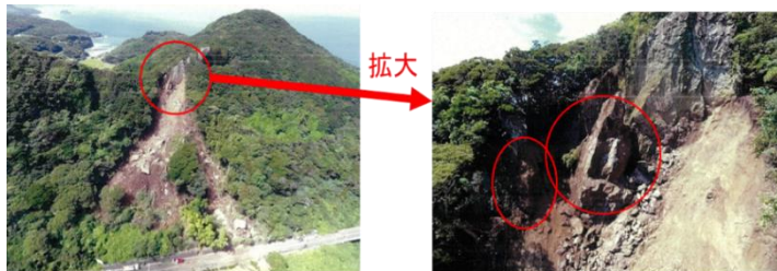
図-1 斜面崩壊による不安定岩塊の残存状況 (長崎県内崩壊現場)
