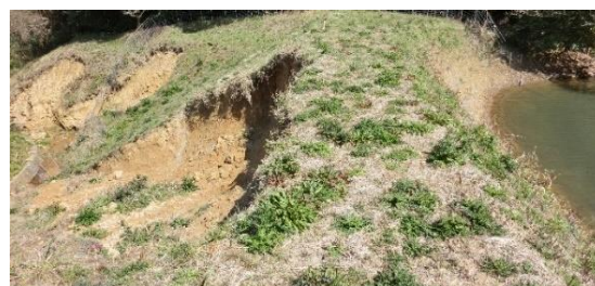
写真-1 吉ノ谷ため池の被災状況
