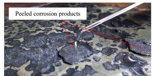
図-6 腐食生成物剥離の様子
