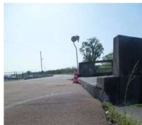
4 月 15 日撮影(段差量約 15cm)
