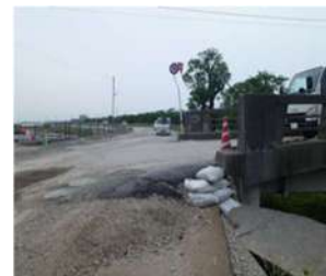
5 月 13 日撮影(段差量約 30cm)
