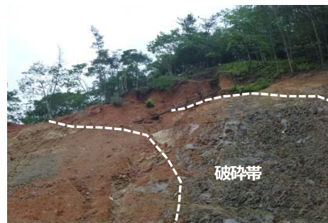
写真2 断層破碎帯に起因するのり面崩壊
